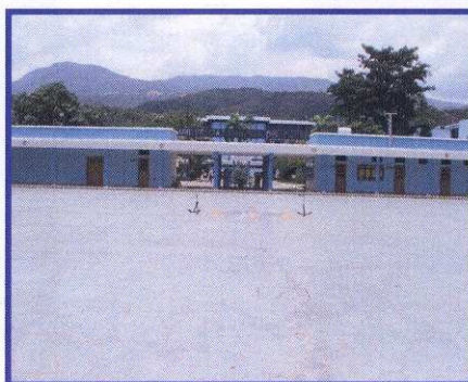
El paso de los años ha dejado sus huellas en el Patio de Honor, lo que amerita la reparación del antiquísimo piso.
